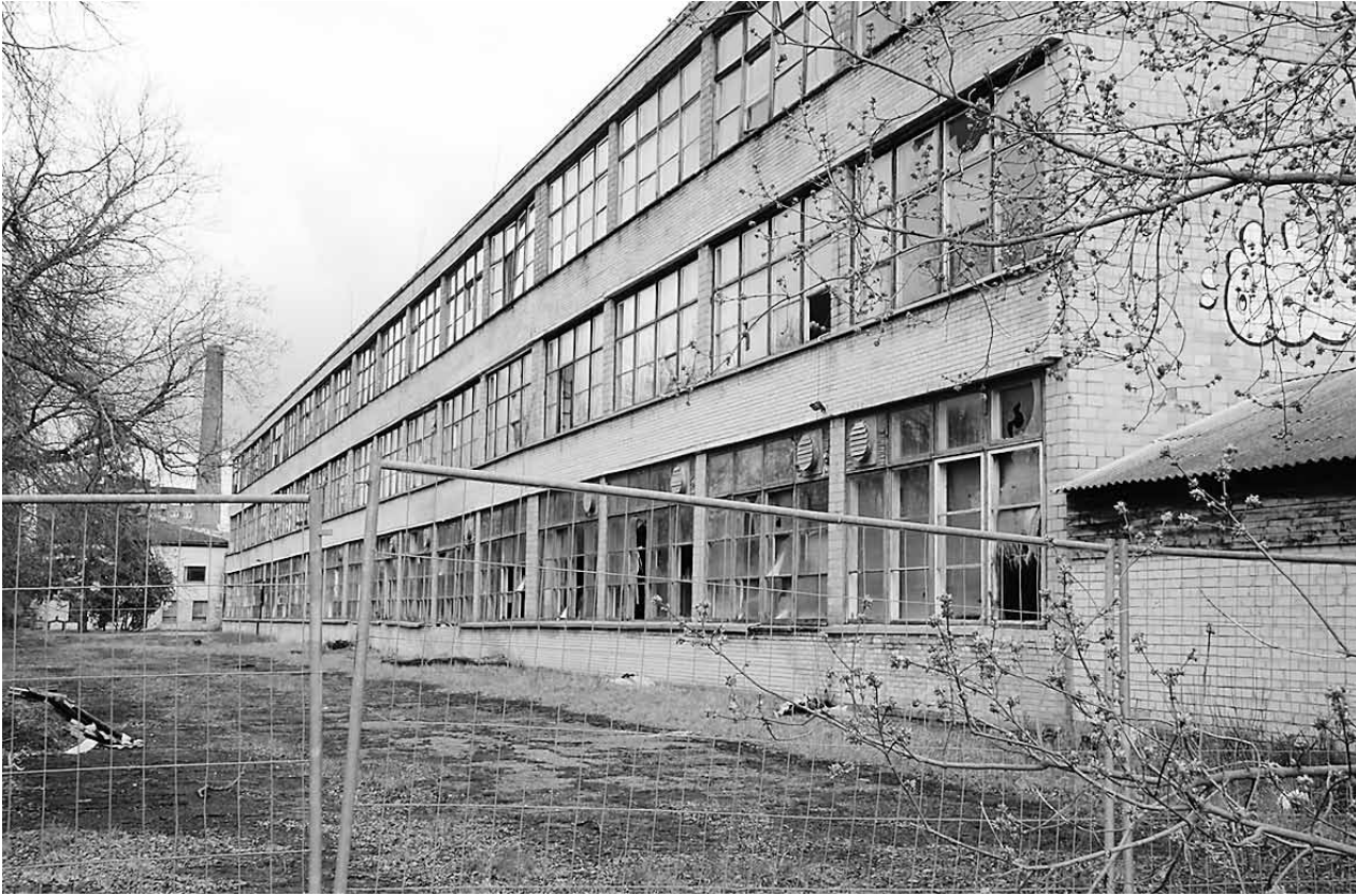
Lõhutud akendega ajalooline tööstushoone.
